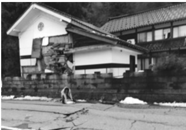
蔵が壊れる。2階の床が脱けた
