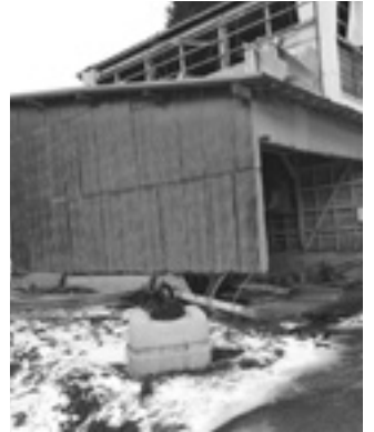
物置が壊れた(手前)。 土台・柱・壁。奥の方の作業所が壊れた。 屋根がずれる。壁が外れる。
